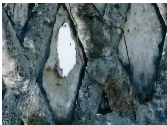
なまこ壁の劣化
