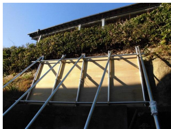
玉泉寺(国指定史跡)石垣の崩落
